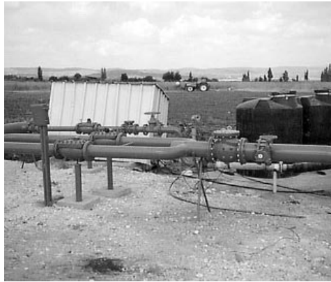
全土に張り巡らされた灌漑パイプ。下水も再利用され、その水は赤色に塗ったパイプで配管されていた（小塩幹雄氏撮影）
